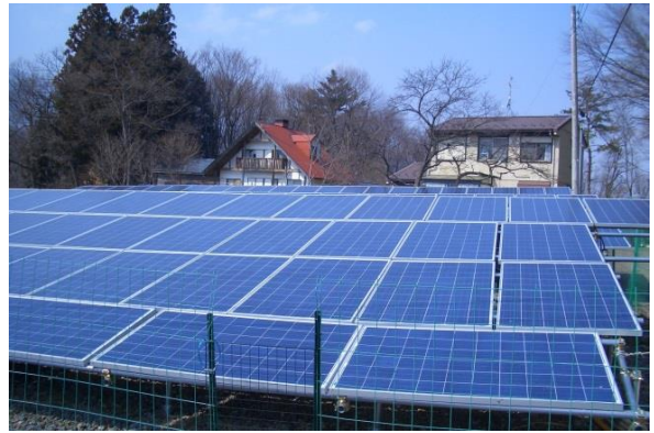
太陽光施設が設置されている小淵沢の現地
