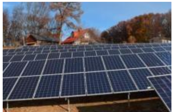
渡部さんの隣に建設された新たな太陽光施設
